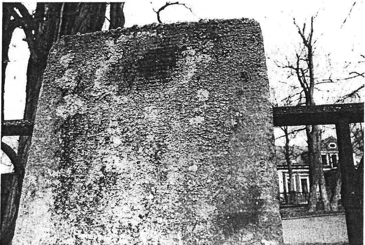
Strona północna, degradacja elementów ogrodzenia
