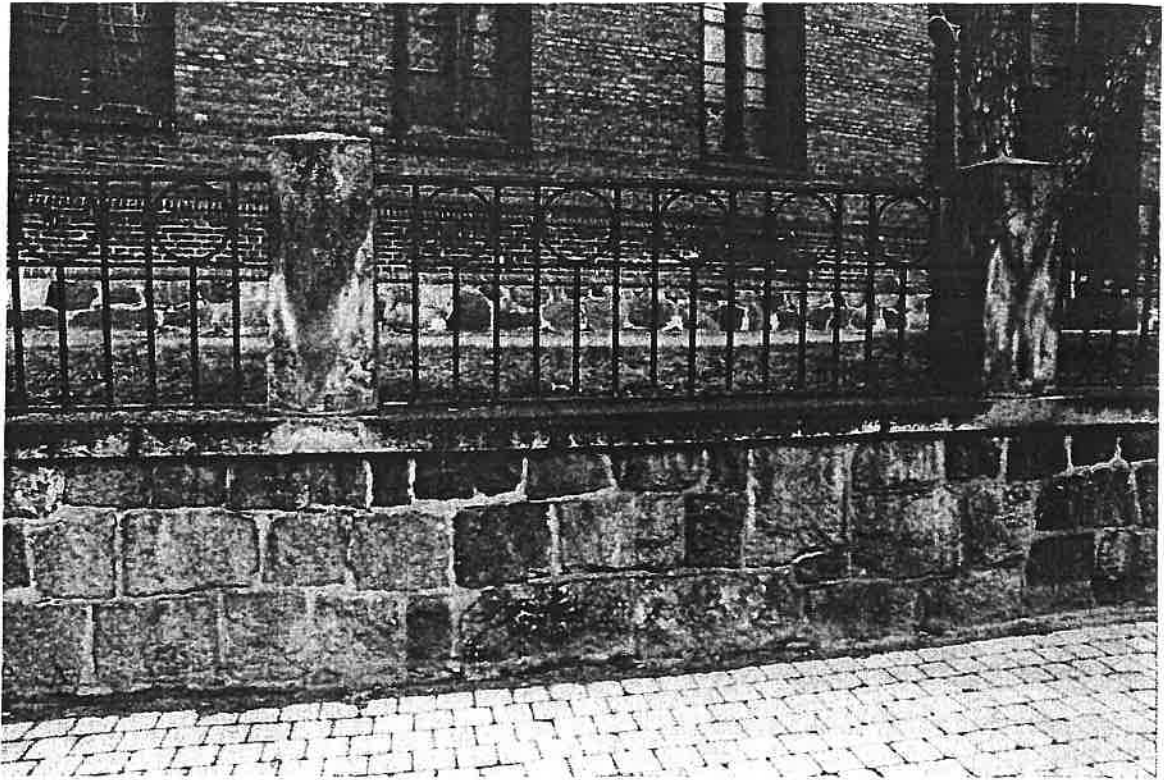
Widok ogrodzenia, ogólne zabrudzenia i porosty
