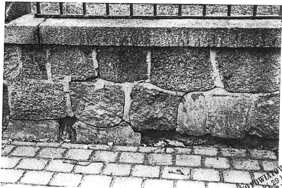
Degradacja podmurówki od strony północnej
